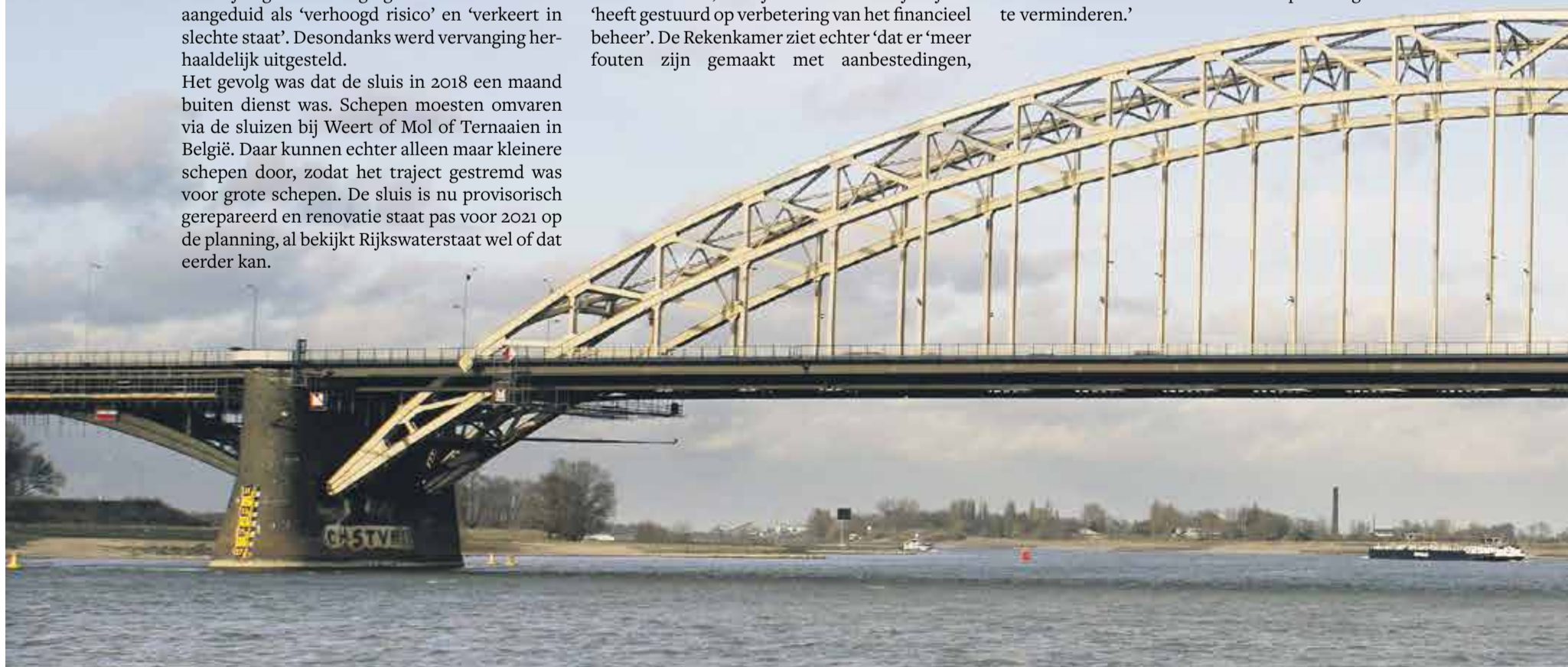
De Rekenkamer uit forse kritiek op Rijkswaterstaat met de constatering dat geen van de sluisen en bruggen die afgesloten zijn geweest, waren aangemerkt als achterstallig onderhoud. Foto: Hollandse Hoogte
